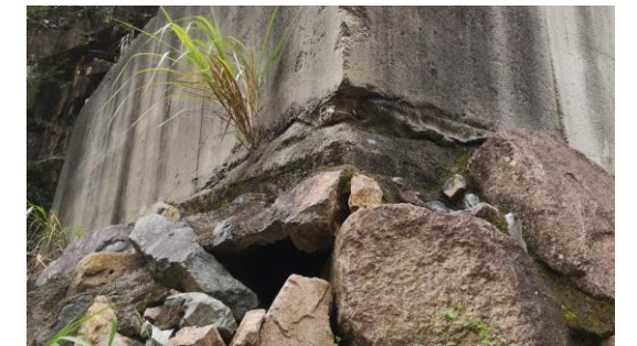
图 3-8 右幅 2#墩桩基裸露
