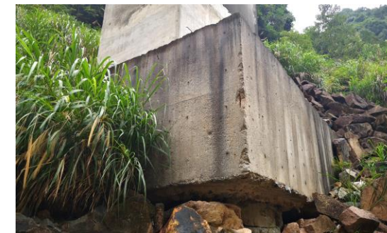
图 3-9 右幅 3#墩桩基裸露
