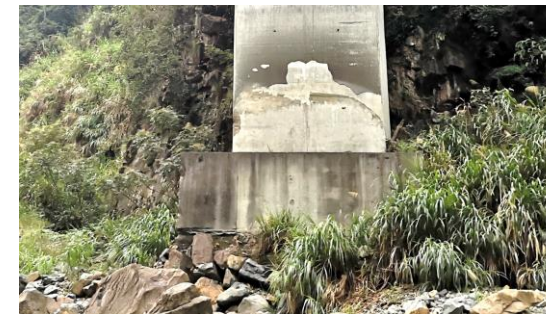
图 3-7 右幅 2#墩桩基裸露
