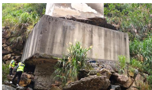
图 3-5 左幅 3#墩桩基裸露
