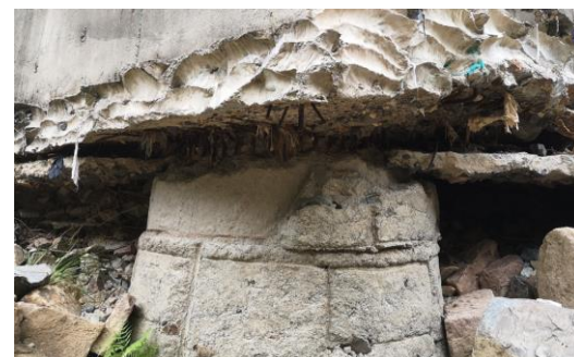
图 3-3 左幅 2#墩承台冲刷、桩基裸露
