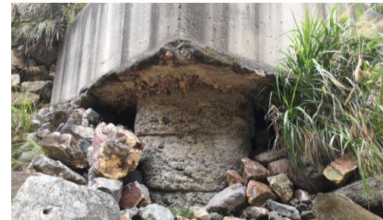
图 3-6 左幅 3#墩桩基裸露
