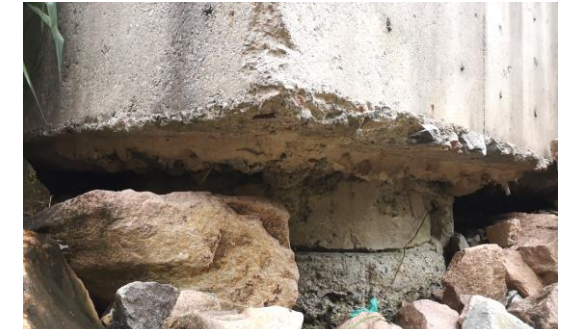
图 3-10 右幅 3#墩桩基裸露
