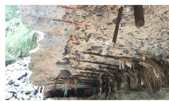
图 3-4 左幅 2#墩桩基钢筋裸露
